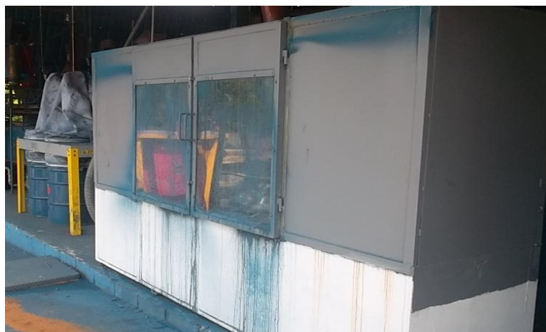
Figura 2 – Imagem do Exaustor instalado na base da Fogás
