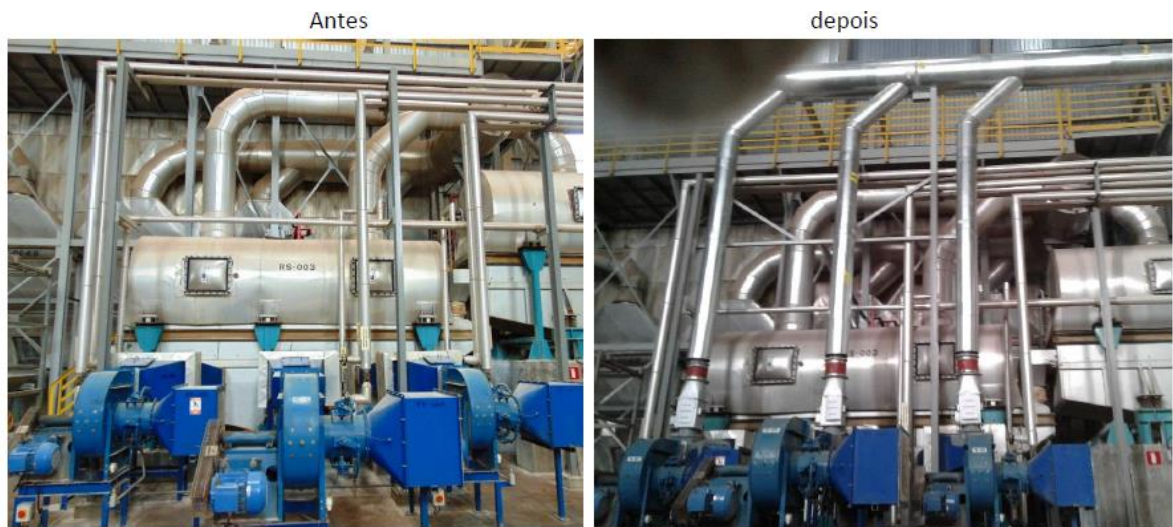
Figura 4 – Vista parcial do sistema de aquecimento secundário: tubulão e suas derivações, três grupos de dampers automáticos para controle do fluxo secundário.
