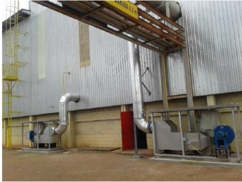
Figura 5 – Vista dos geradores de ar quente instalados no lado externo da planta
