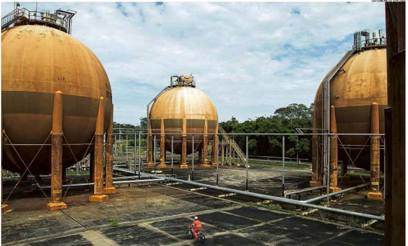
'Choque': Unidade produtora de gás da Petrobras na Amazônia: o governo prevê crescimento de 2,1% no PIB industrial a cada 10% de redução no preço do gás, em consequência da abertura do setor
