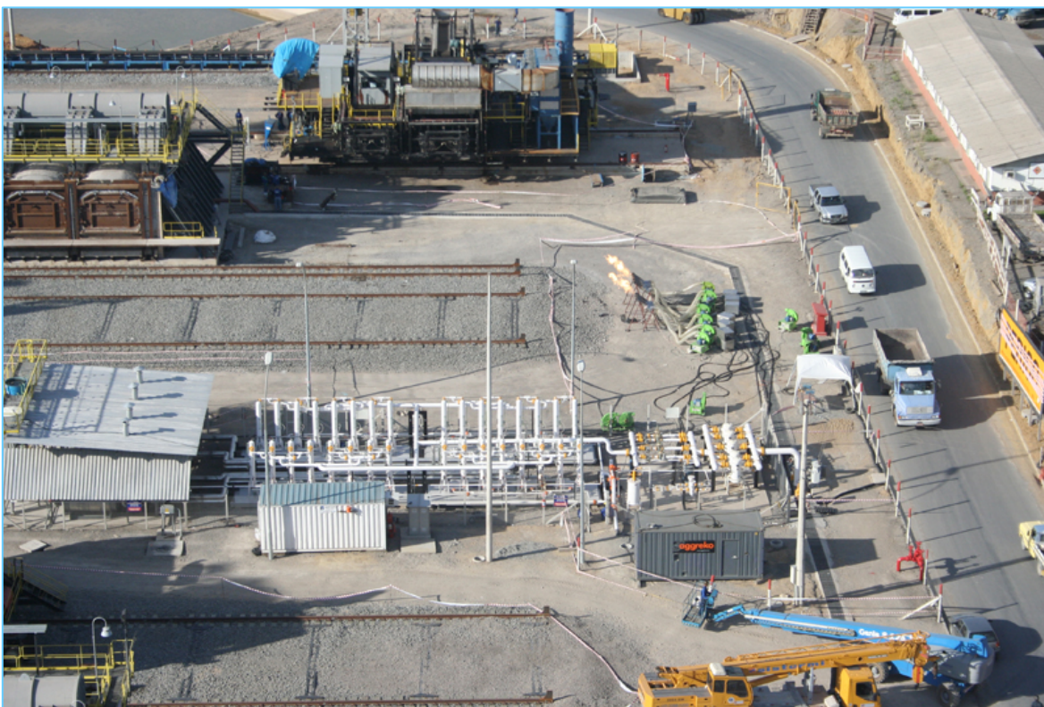
Figura 3. Central de Vaporização de GLP.
