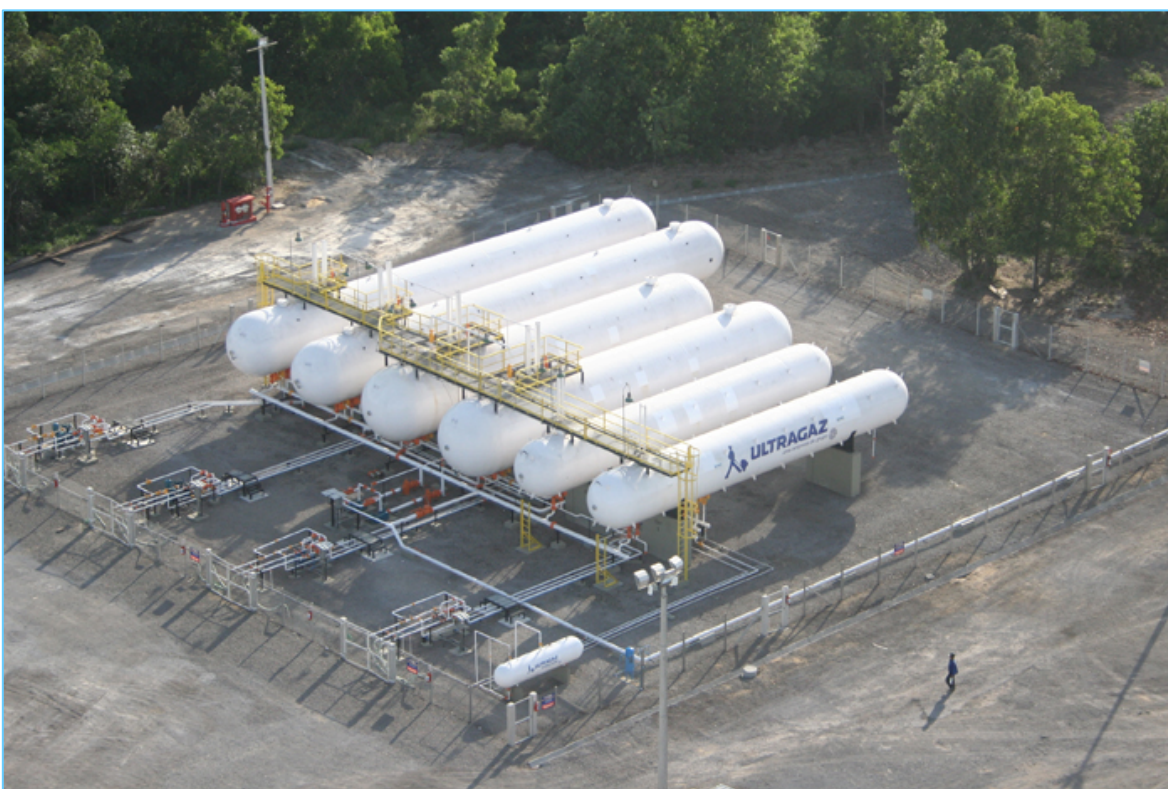
Figura 2. Central de armazenagem de GLP.
