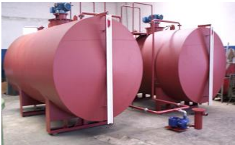
Figura 4 – Tanques de armazenagem da tinta
