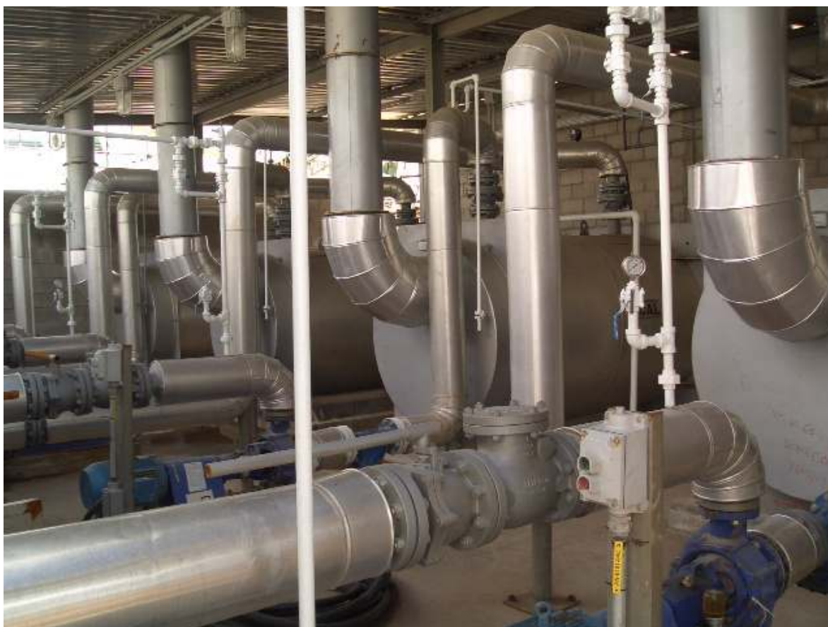
Figura 5: Central de geração de água quente
