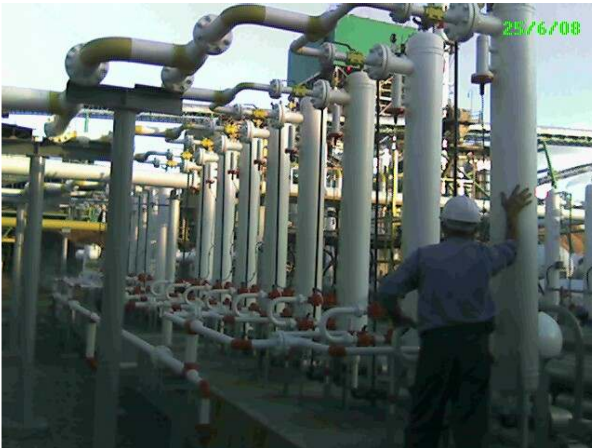
Figura 4: Central de vaporização
