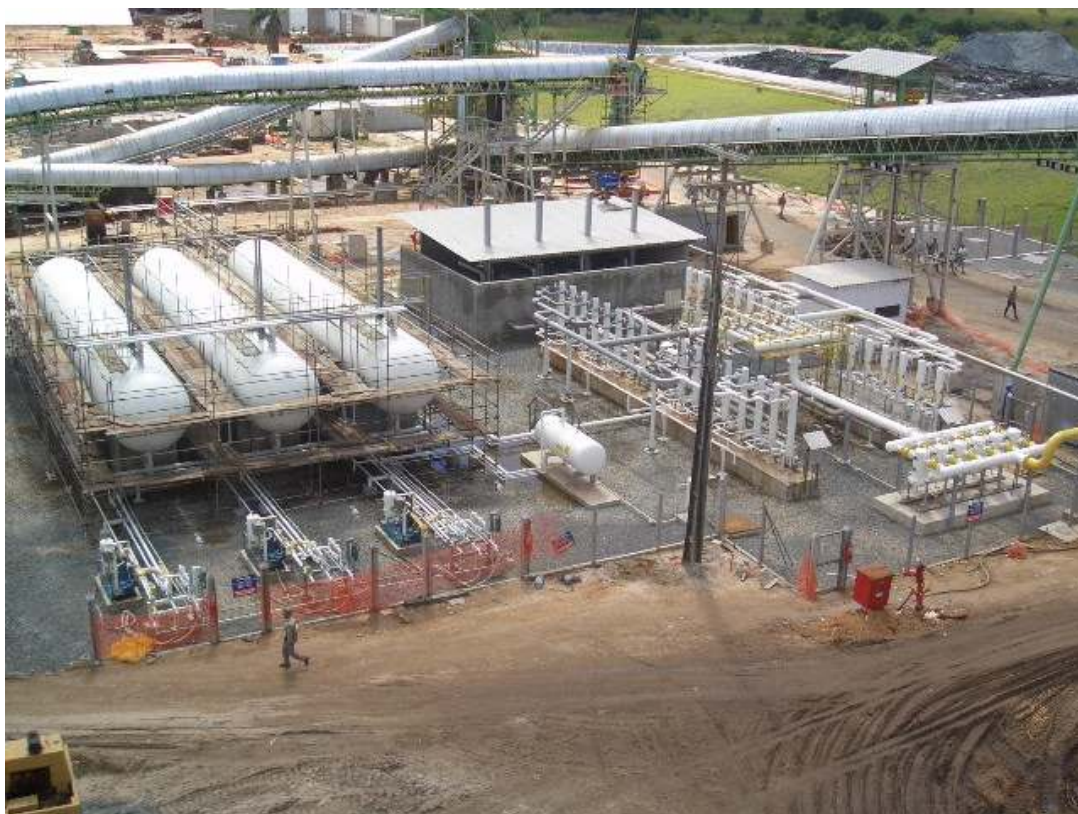
Figura 3: Central de Gás LP
