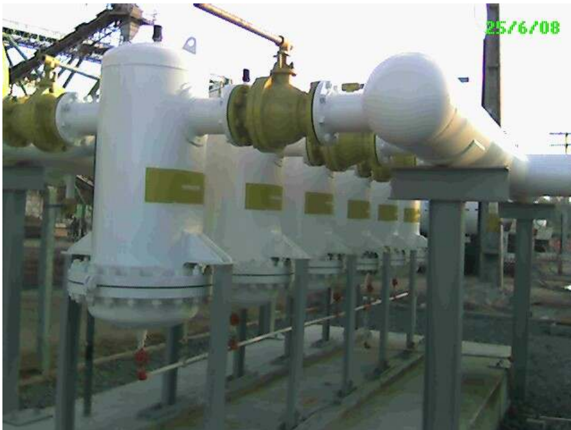
Figura 6: Filtros coalescentes e saída para consumo de Gás LP.
