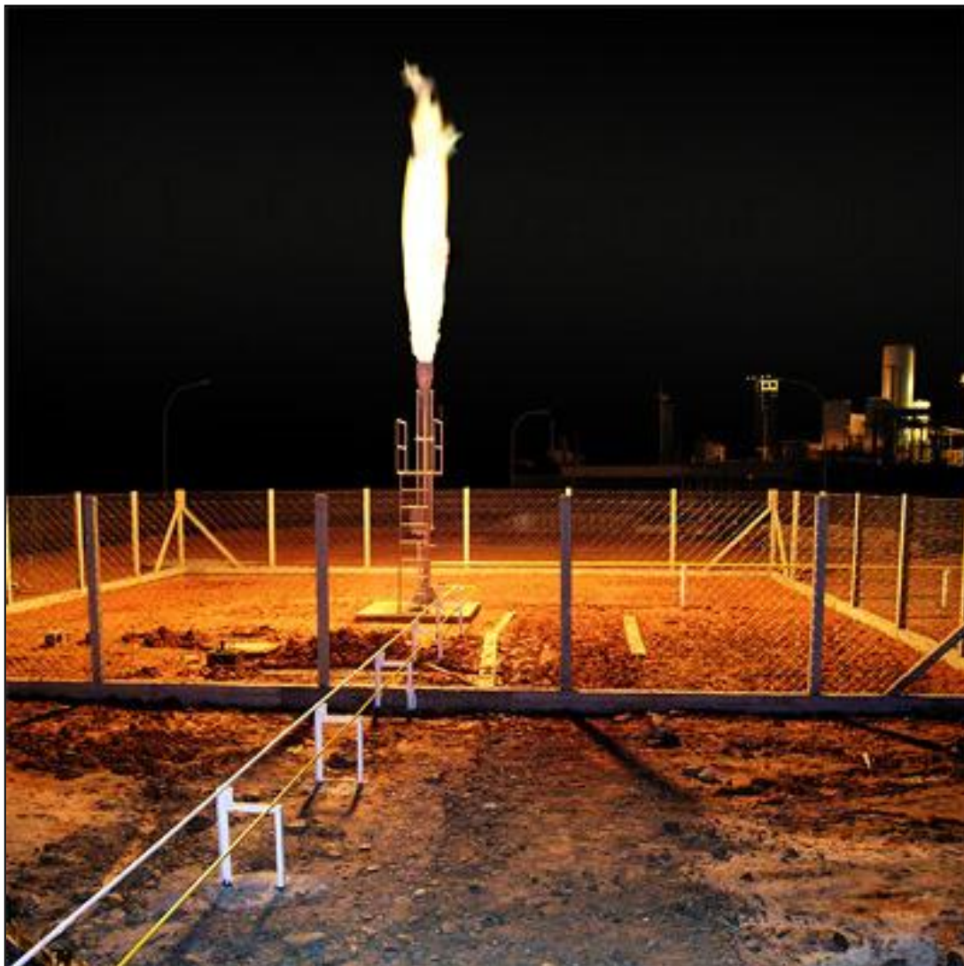
FIGURA 7. Flare em operação com GNS
