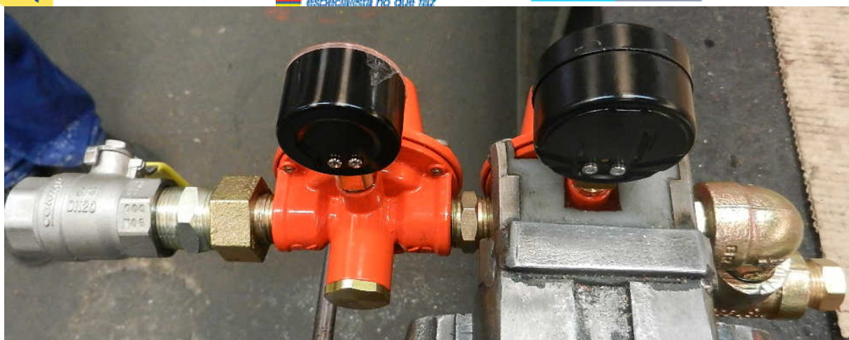
Figura 4 – Montagem final do sistema de regulagem de pressão
