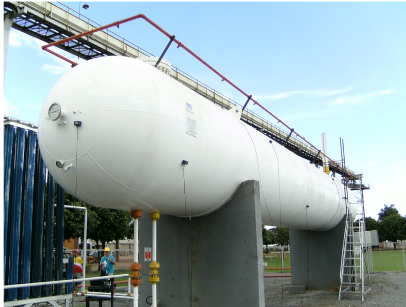
Figura 2 – Tanque de GLP preparado para teste com EA. Os sensores estão colocados de forma distribuída, em disposição triangular.
