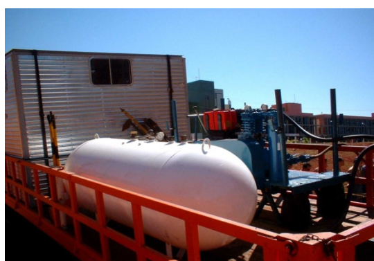
Figura 10 – Carreta com tanque de GLP e bomba para a pressurização com 5 a 10% acima da pressão operacional
