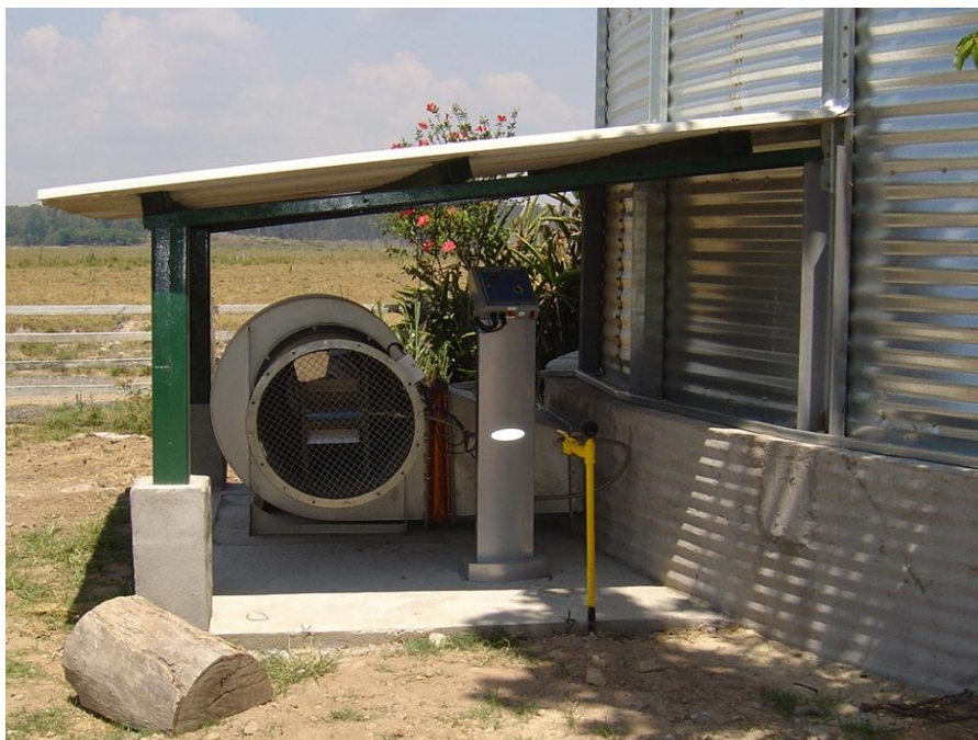
Figura 2. Foto do silo e do sistema de combustão.
