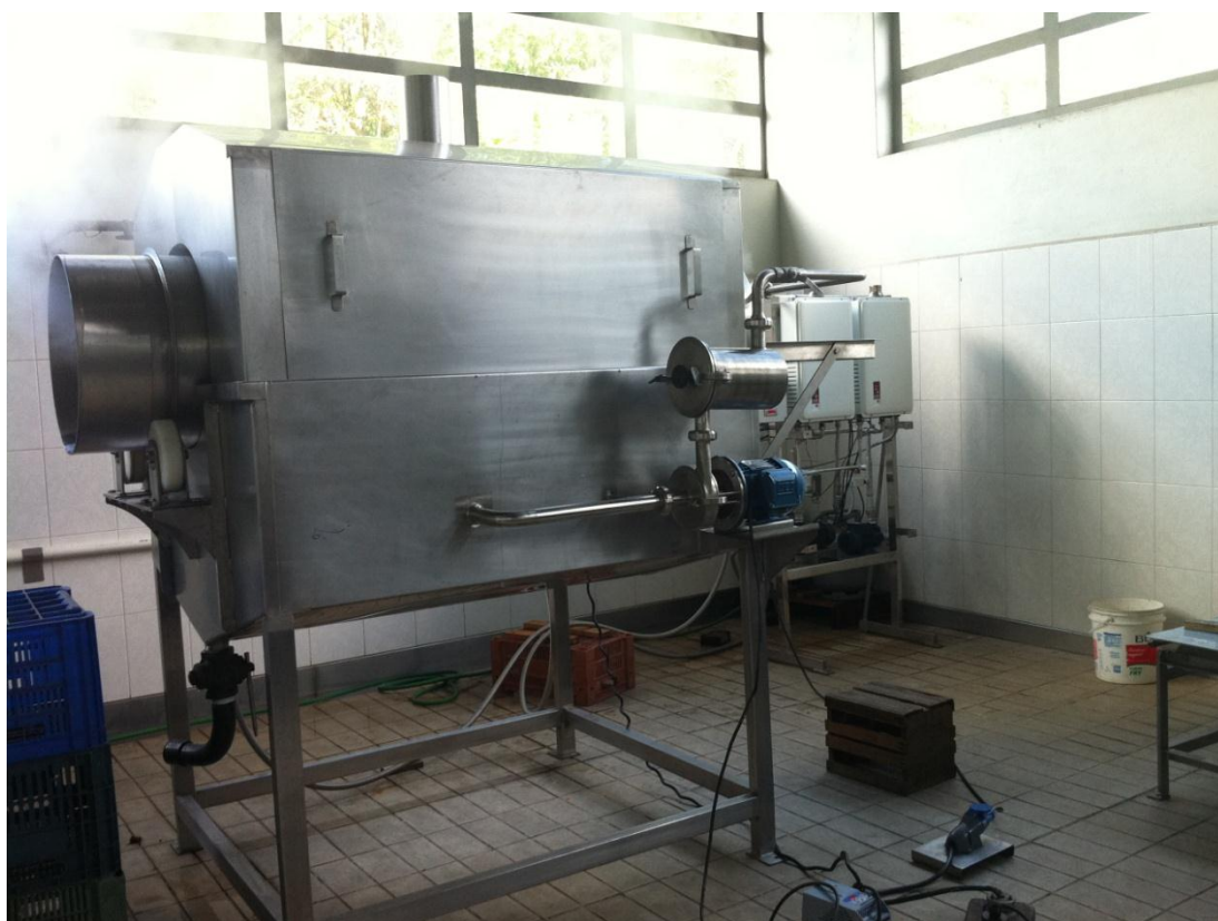
Fig. 4 – Equipamento instalado em cliente Ultragas
