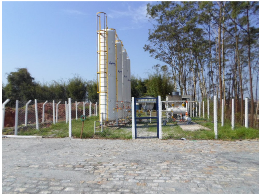
Central de Gás
