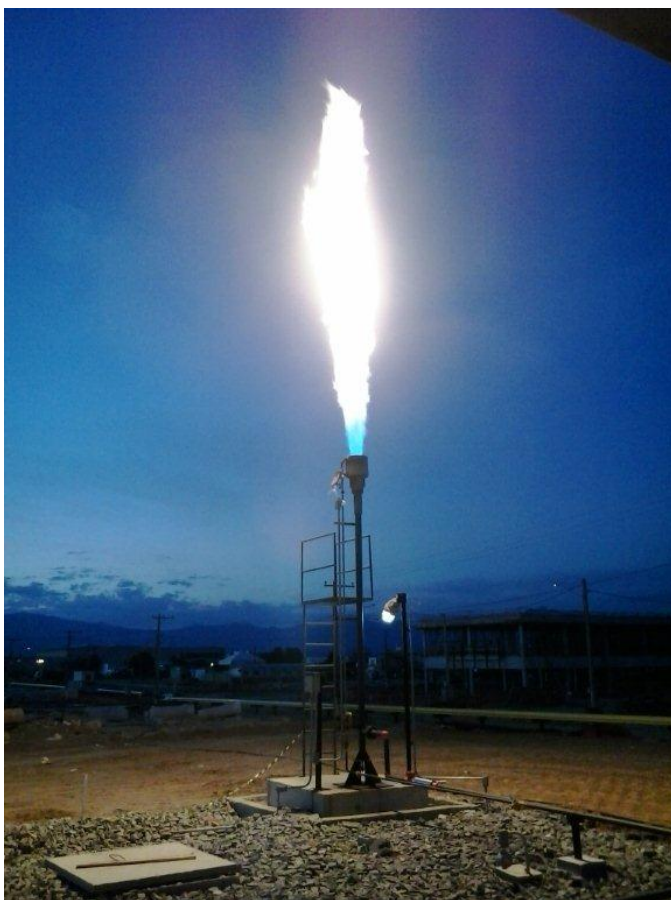
FIGURA 4. Flare para queima de gás
