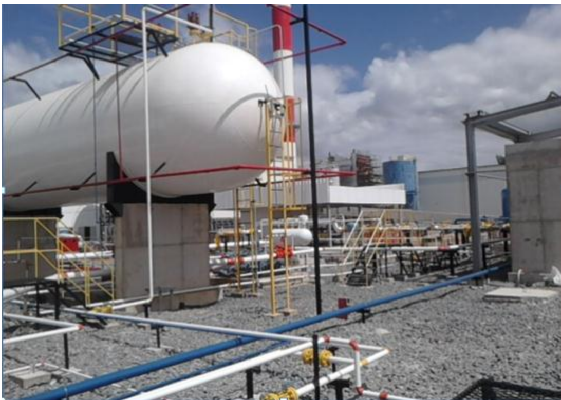
Figura 3. Vista geral da central de GNS
