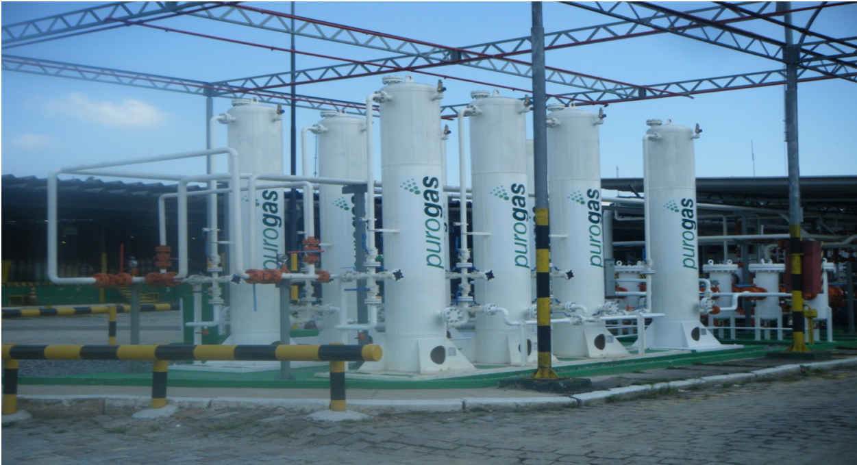
Fig.04: conjunto de filtros e colunas de filtragem
