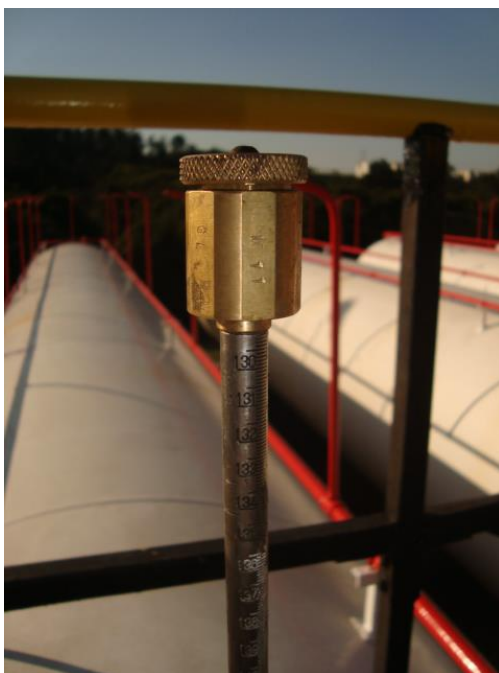
Foto 5 – Detalhe da VCA instalada na vareta medidora
