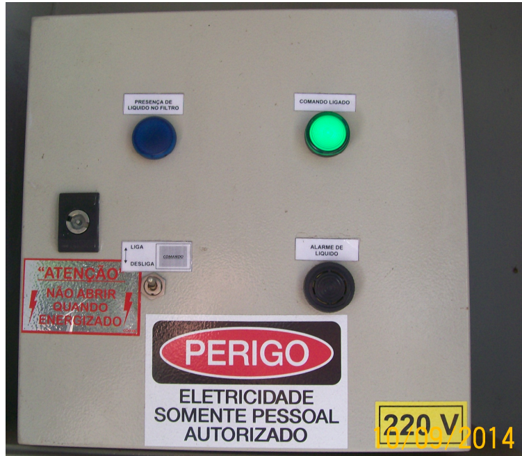
Painel elétrico de comando e sinalização sonora e visual
