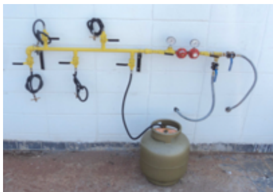
Alimentação do aquecedor de piscina.
