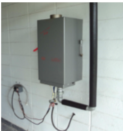
Painel de comando da sauna - queimadores.
