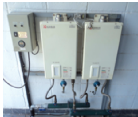
Aquecedor utilizado somente o da esquerda de baixa pressão com regulador de pressão azul.
