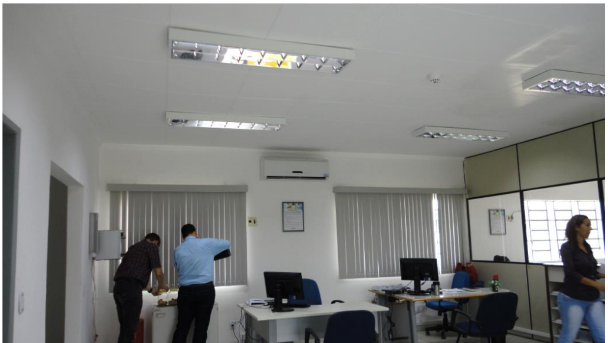
Foto 06: Iluminação LED na área administrativa
