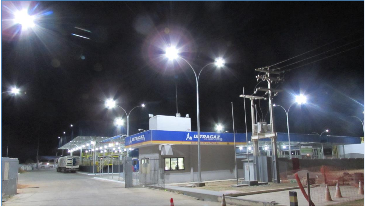
Foto 01: Postes com luminárias LED para iluminação do pátio de manobras e área externa
