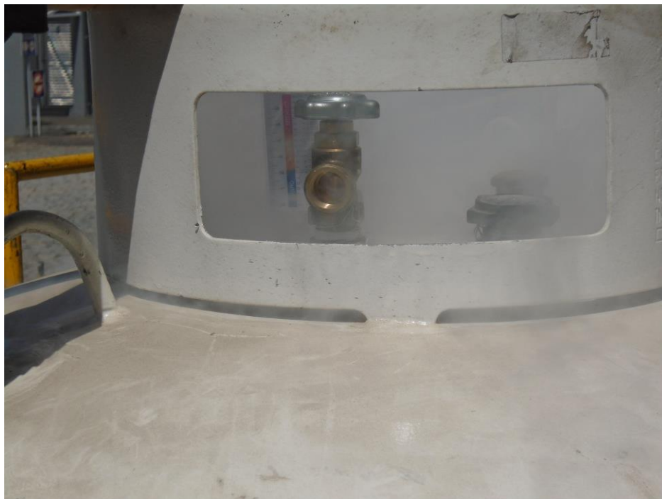
Foto 5 – névoa de gás com a válvula atual
