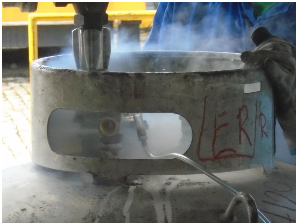
Foto 11 - Captação da emissão com a nova válvula
