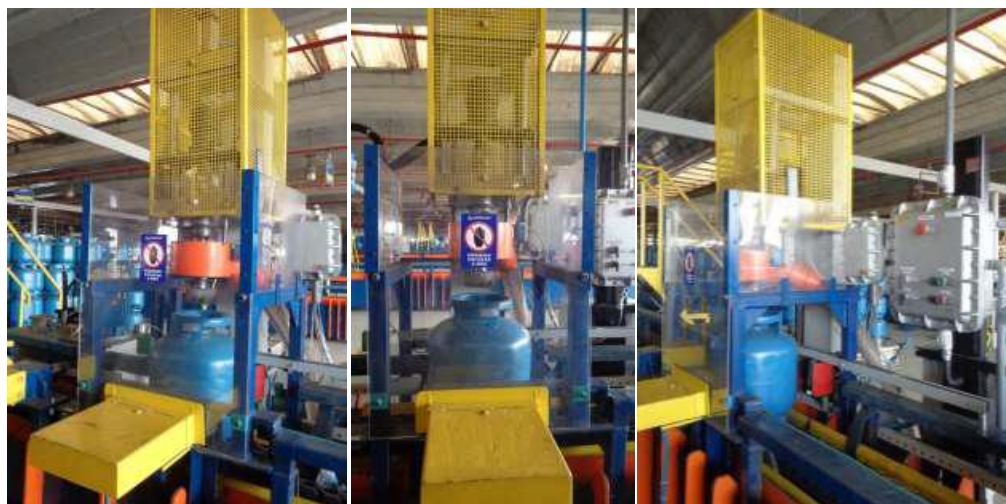
Imagem 04: Equipamento Automático de Retirada da válvula (frente)
