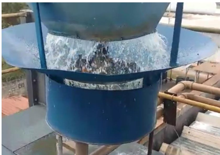
Figura 3 - Saída do Chaminé com Lavador Interno Instalado
