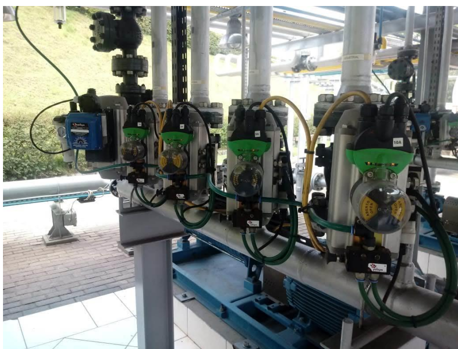
Figura 7 - Válvulas do header das bombas e válvula de controle
