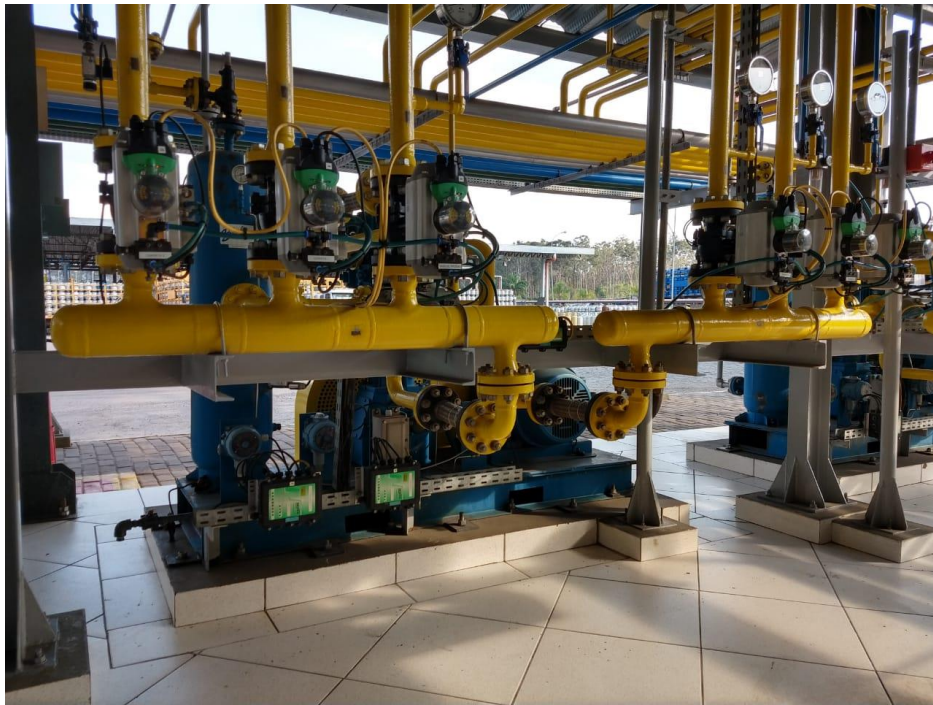
Figura 8 - Compressores com válvulas e remotas de monitoramento em rede ASi
