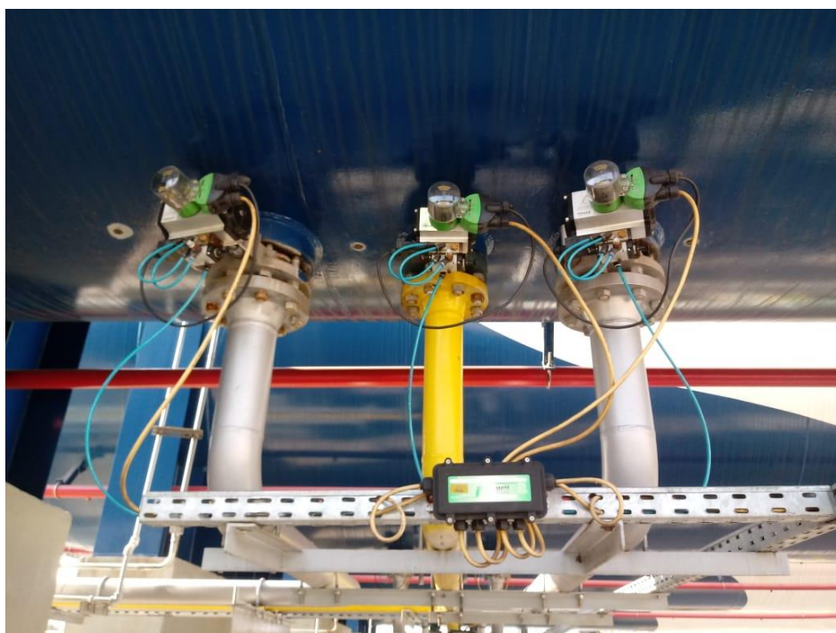
Figura 12 - Válvulas de fundo de tanque automatizadas
