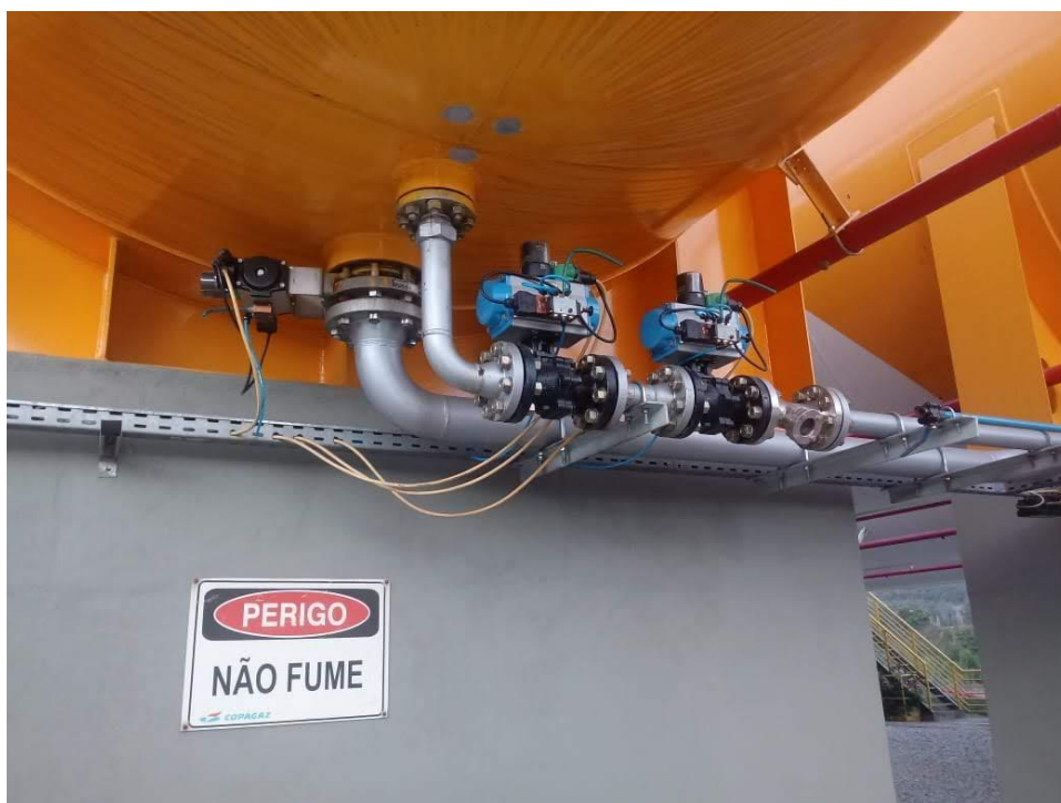
Figura 14 - Válvula de drenagem de oleína e água
