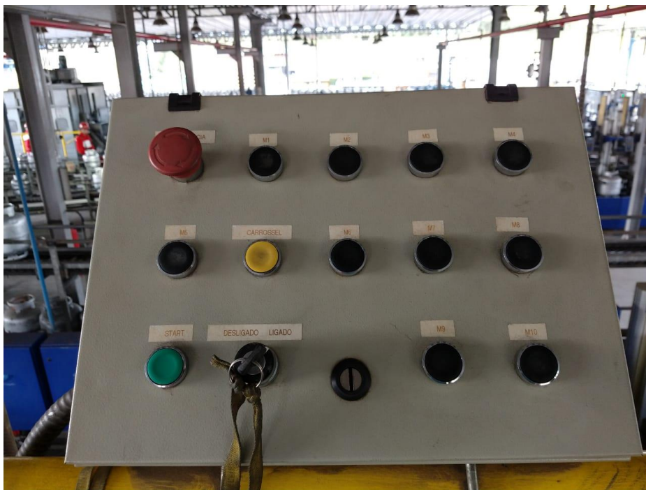
Figura 17 - Paine de comando dos transportadores da plataforma
