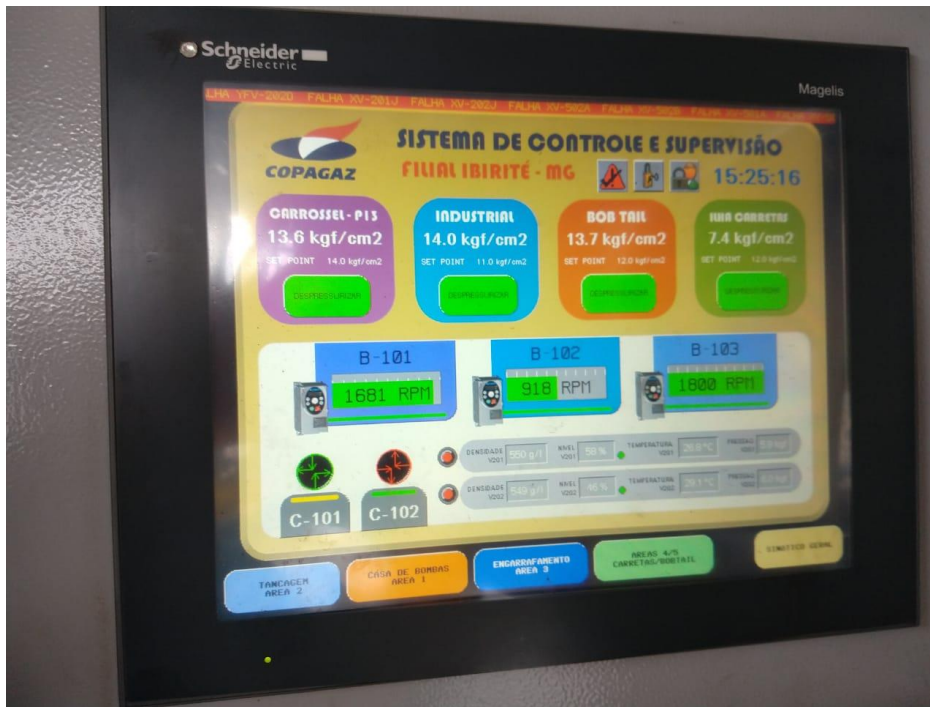
Figura 2 - Tela principal de comandos – IHM casa de bombas
