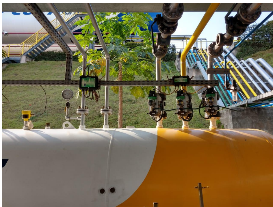
Figura 6 - Remotas Profibus e válvulas automatizadas - tanque de decantação
