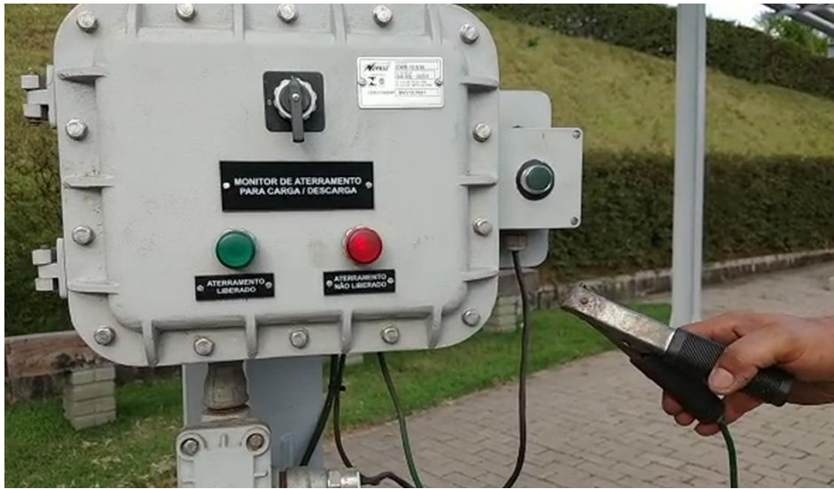
Figura 16 - Sistema de monitoramento de aterramento interligado com automação
