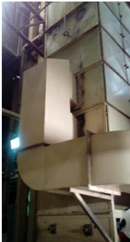
Figura 2 - Dutos por onde o ar quente é insuflado para o interior da torre de secagem.
