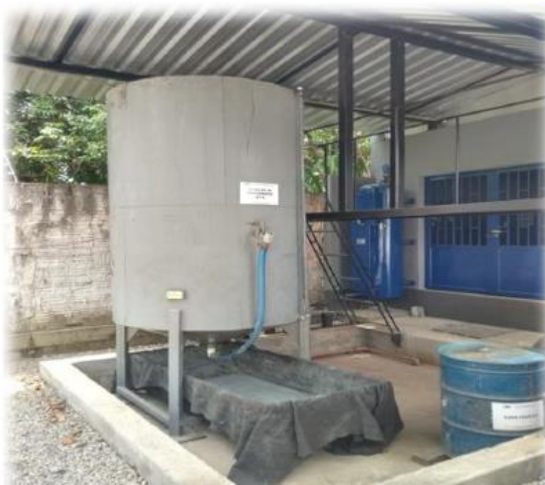
Imagem da Estação de Tratamento de Efluentes
