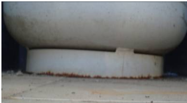
Figura 4- Argola inferior oxidada
