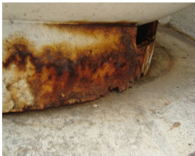
Figura 7- Argola inferior com corrosão avançada
