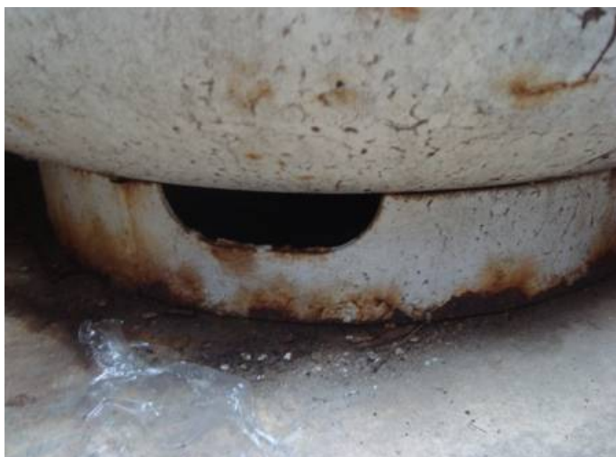
Figura 6- Argola inferior com início de corrosão
