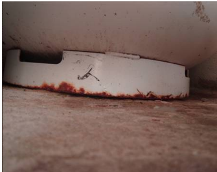
Figura 5- Argola inferior oxidada
