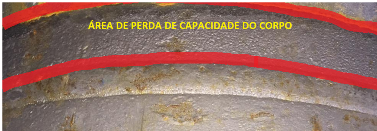
Imagem – Área de perda de capacidade do corpo (solda)
