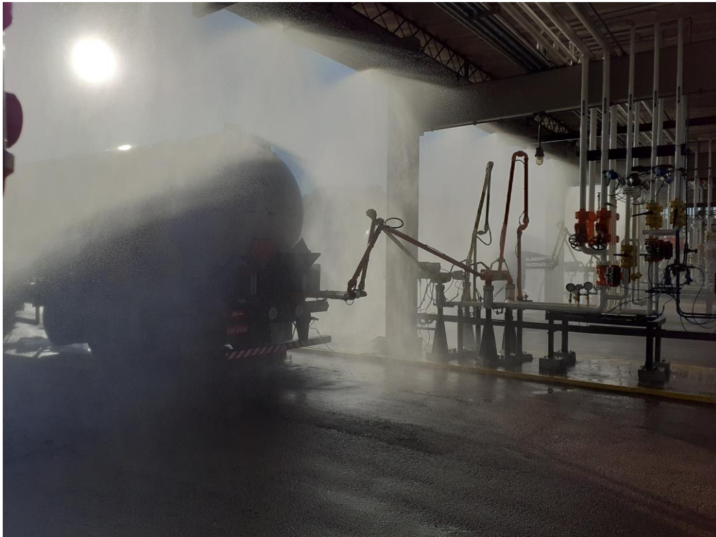
Acionamento – N6 – Boxes de Carregamento
