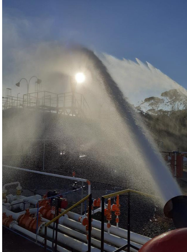
Acionamento – CMH3/CMH4 – Tanques GLP/Ponto B
