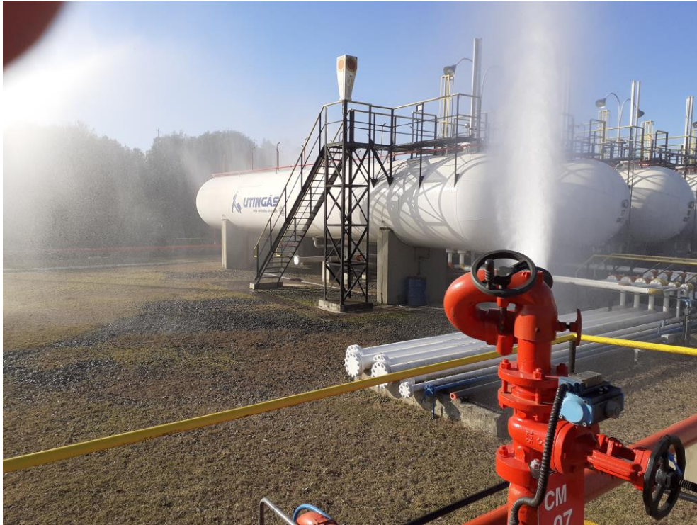
Acionamento – CM7 – Tanques GLP
