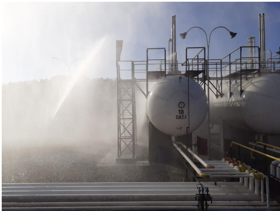
Acionamento – CM7/CM8 – Tanques GLP
