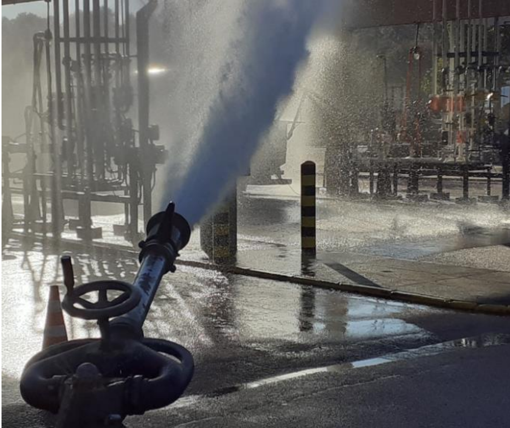
Acionamento – CM1 – Boxes de Carregamento
