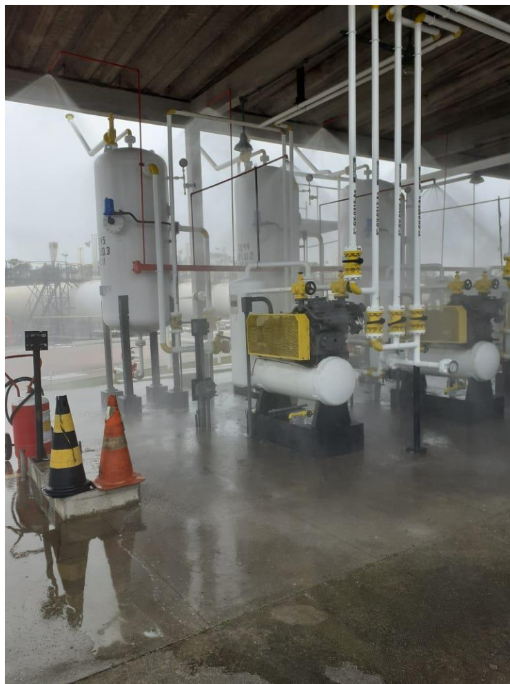
Acionamento N5 – Casa de Compressores de GLP
