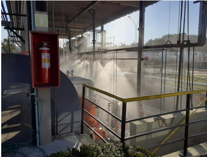
Acionamento – N4 – Casa de Bombas de GLP
