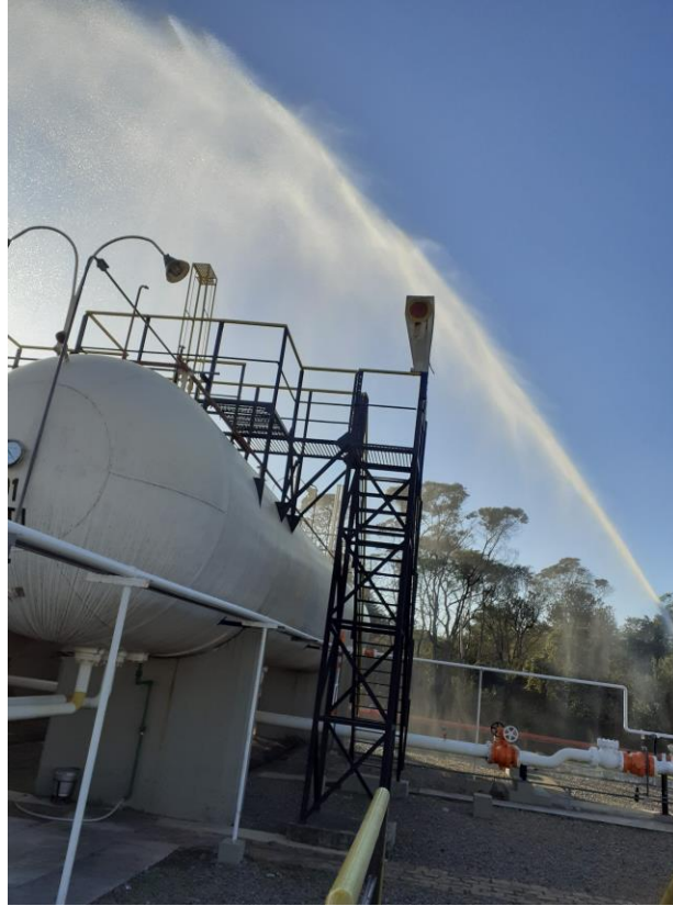
Acionamento CMH4 – Tanques GLP
