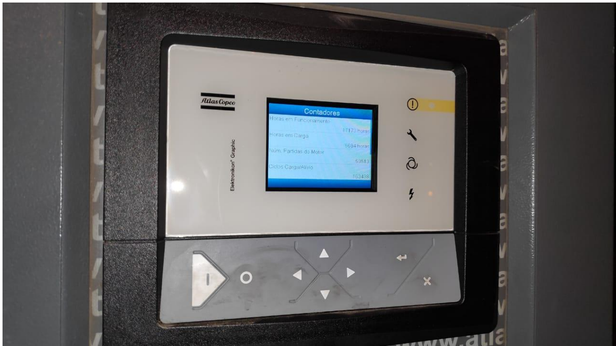
FIGURA 3 - REGISTRO DOS CONTADORES NA IHM DE CONTROLE
