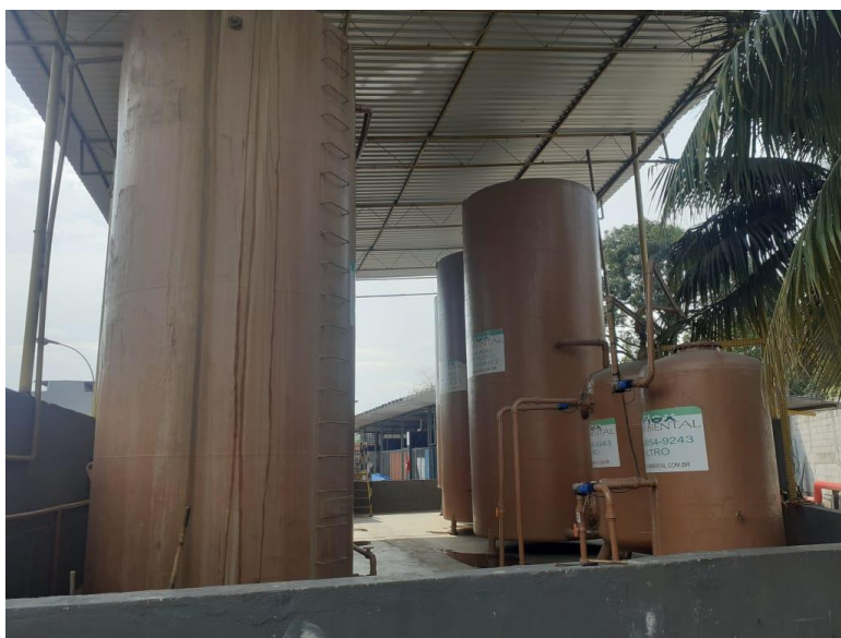
Figura 7 - Estação de Tratamento de Efluentes
