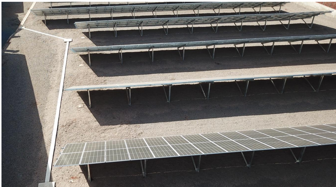
Figura 07 – Placas solares instaladas voltadas ao Norte e com angulação correta.
