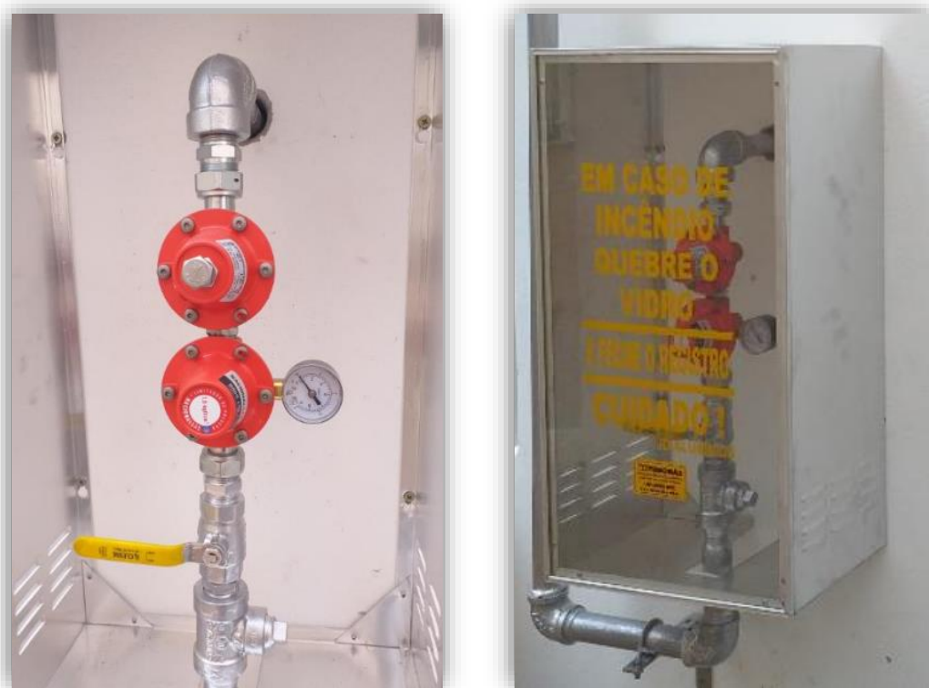
Imagem 8 e 9 – Sistema para regulagem de GLP no 1º estágio (IN008)
