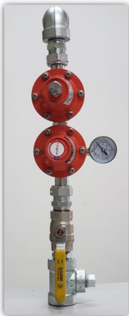
Imagem 7 – Sistema para Regulagem de GLP no 1º Estágio (Posição de instalação)
