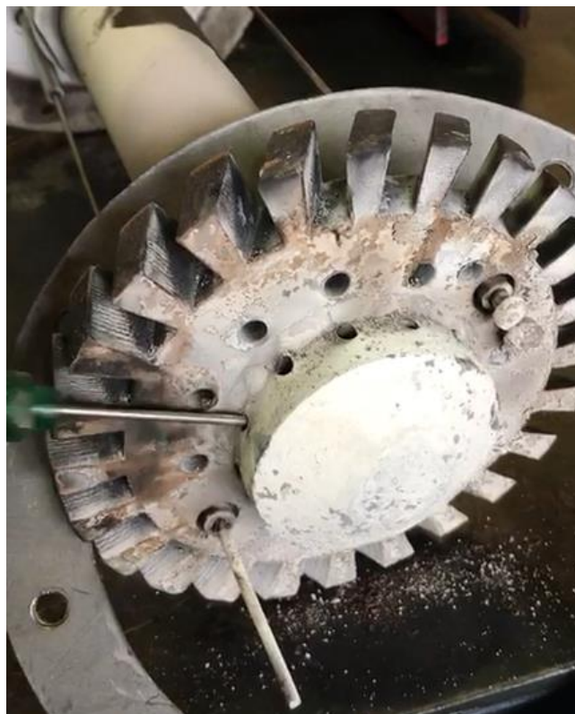
Imagem 1 – Difusor do queimador e partículas metálicas na parte inferior
