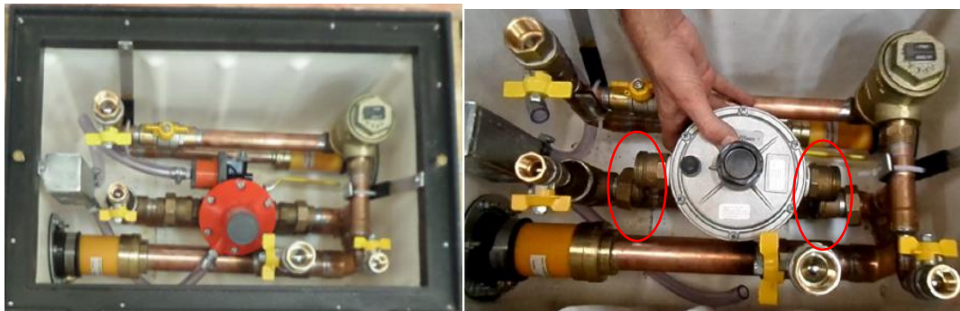
Figura 2 - Falta de intercambialidade entre os reguladores
