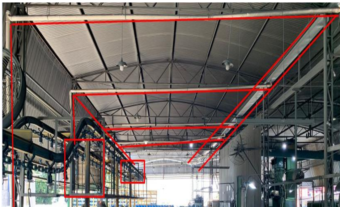
Figura 2 – b) Sistema de coleta e distribuição da água pluvial pelos condutores
