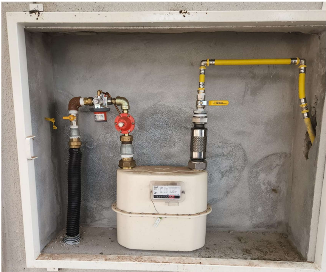
Figura 5 - Regulador AP40 com alívio e OPSO instalado pelo cliente (Arquivo: GasBrasiliانو)
