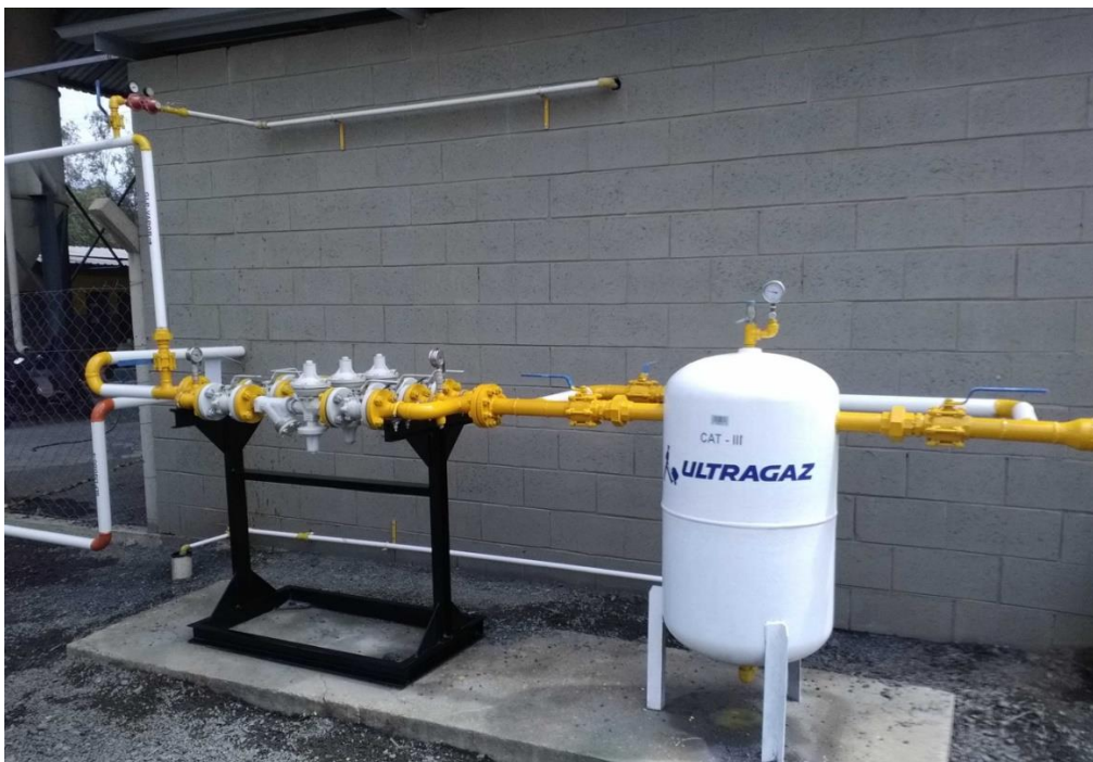
Figura 5 - Foto Central de Gás com o Kit 1000 kg/h de GLP instalado
