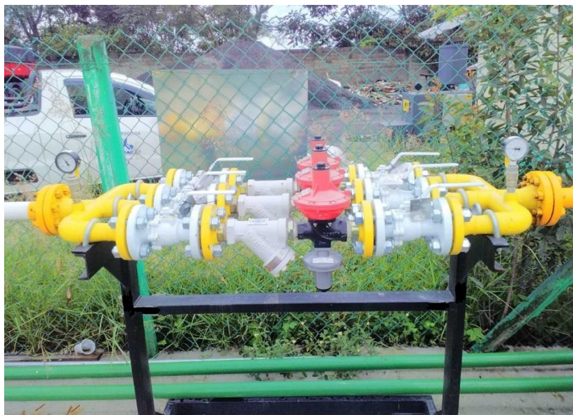
Figura 6 - Kit 1000 kg/h de GLP instalado em campo
