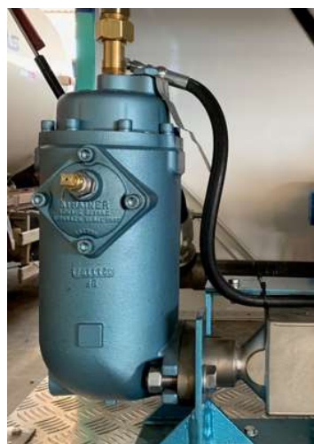
Detalhe da ligação do flexível junto a câmara de vapor
