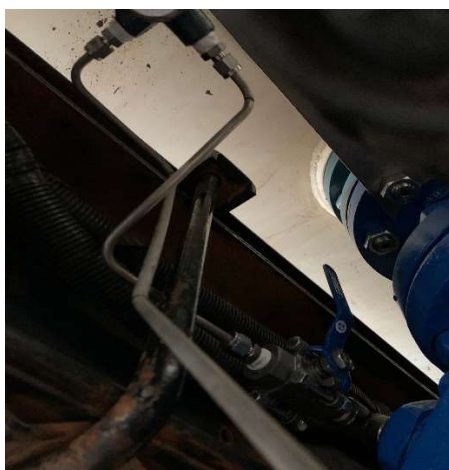
Tubulação de ligação da válvula 3 via na saída lateral da bomba
