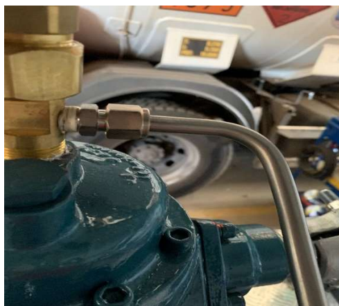
Detalhe da ligação da tubulação de inox com a câmara eliminadora de vapor do medidor mássico
