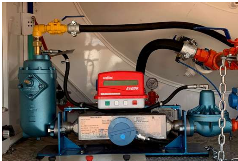
Ligação da câmara de vapor e a válvula diferencial, com mangueira flexível
