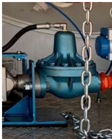
Detalhe da ligação do flexível junto a válvula diferencial
