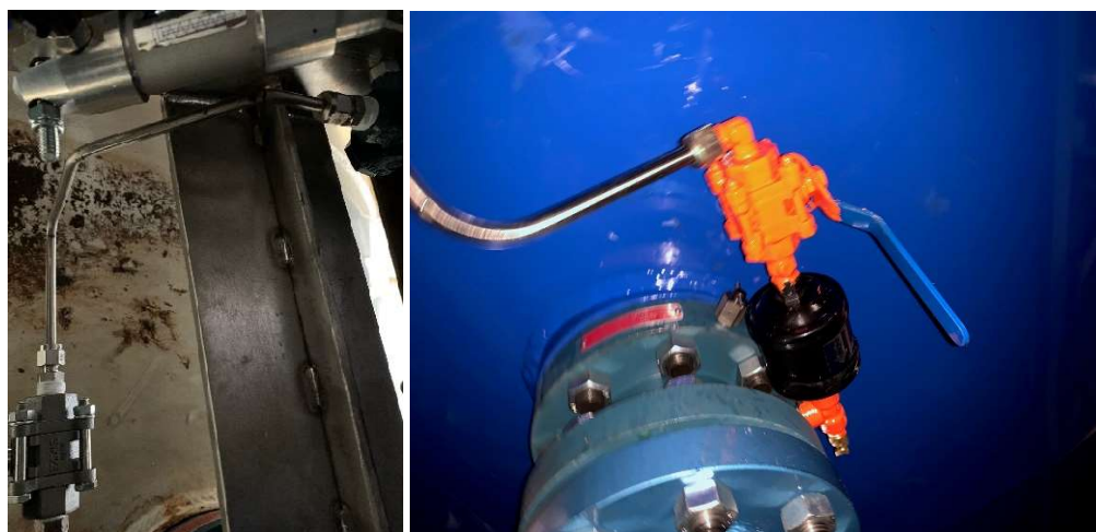
Tubulação de ligação da válvula 3 vias no filtro da válvula de fundo
