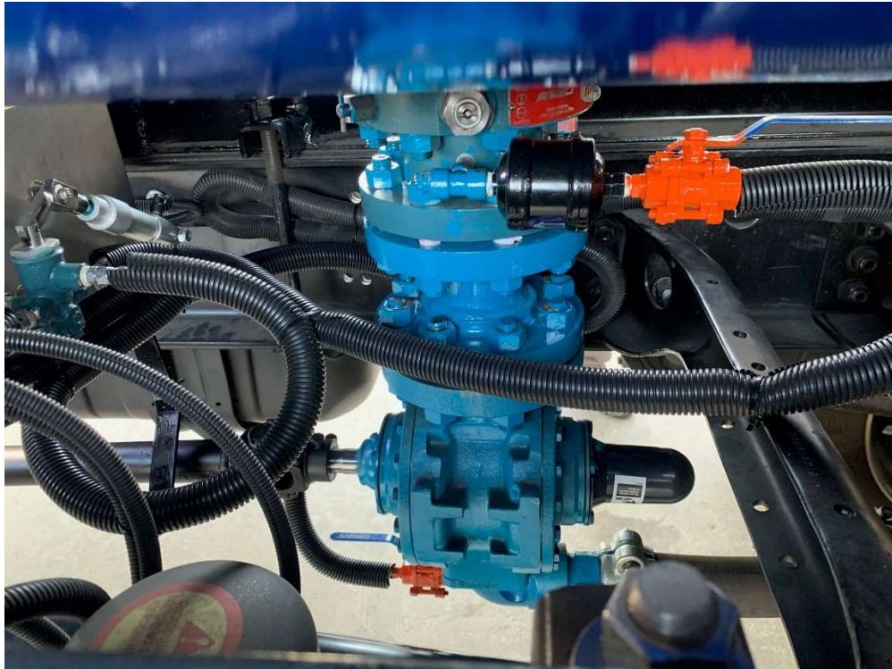
Ligação da válvula de fundo junto a válvula 3 vias e a bomba, através de mangueira flexível
