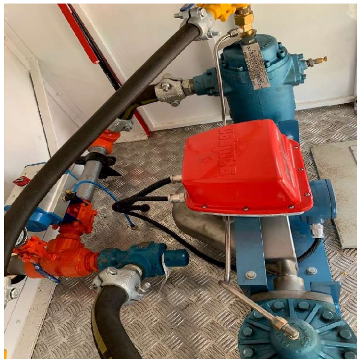
Ligação da câmara eliminadora de vapor com a válvula diferencial do medidor mássico
