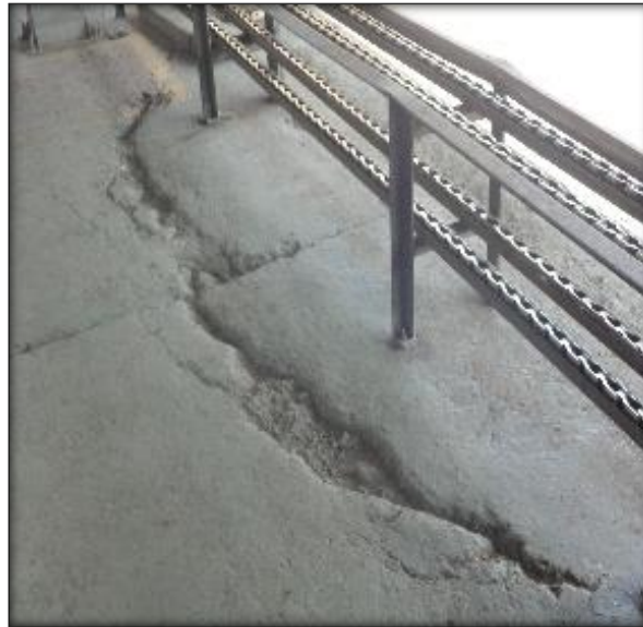
Figura 1 - Crateras no piso do plant de envase
