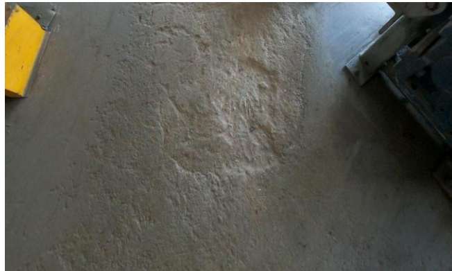
Figura 2 - Desgaste acelerado em piso de concreto exposto
