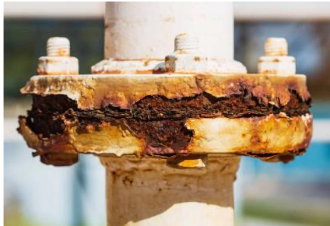
Figura 10 - Corrosão em fresta
