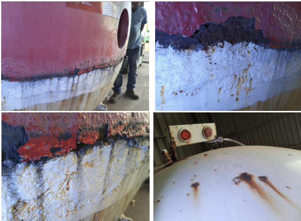
Figura 2 - Vasos de pressão com corrosão
