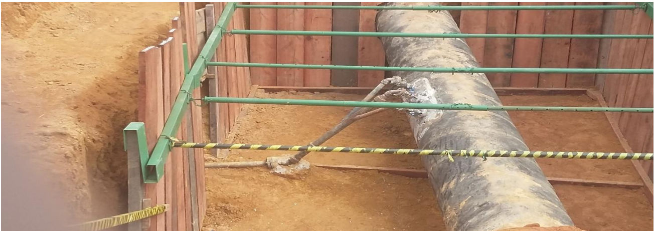
FIGURA 9 – Duto perfurado para roubo de combustível
