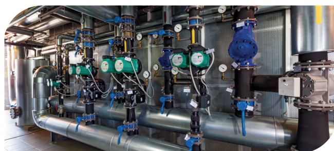
Geradores de vapor, caldeiras e bombas de calor.
